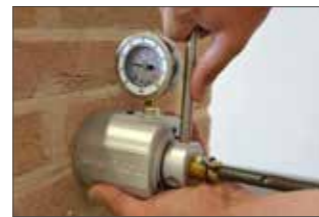
ΕΚΤΕΛΕΣΗ PULL OUT TEST ΣΤΟ ΕΡΓΟΤΑΞΙΟ ΜΕΣΩ ΠΙΣΤΟΠΟΙΗΜΕΝΗΣ ΔΟΚΙΜΗΣ ΕΞΟΛΚΕΥΣΗΣ. ΕΛΕΓΧΟΣ ΤΗΣ ΑΝΤΟΧΗΣ ΤΗΣ ΑΓΚΥΡΩΣΗΣ
