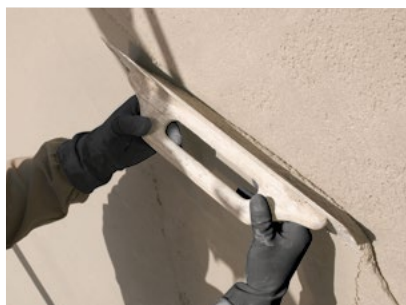
Finition et décoration de Geocalce Tenace
